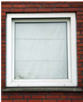
Nyt plastvindue i oprindeligt murhul
