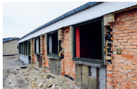
4 huse blev nedrevet og genopført på grund af dårlig fundering. Yderligere 1 hus er nedrevet og genopført efter skader under renoveringen
